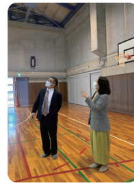
体育館の屋根は雨漏りのため継ぎ接ぎにて修復の繰り返し。
