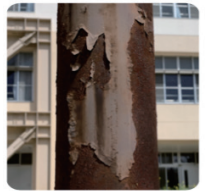
使用していない電灯が数本、撤去されずにさびついている。
