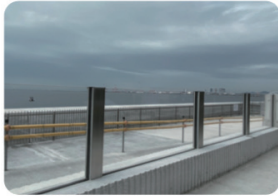
アクリル板設置箇所
