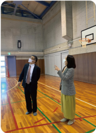
体育館の屋根は雨漏りのため 継ぎ接ぎにて修復の繰り返し。
