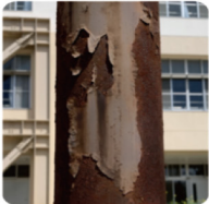
使用していない電灯が数本、 撤去されずにさびついている。
